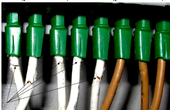
Fig. 7.1 – Efectul îmbătrânirii în condiții puțin severe de solicitare. Toți conductorii din imagine fac parte dintr-un același cablu; materialele de culoare albă prezintă numeroase fisuri (marcate cu săgeți)
